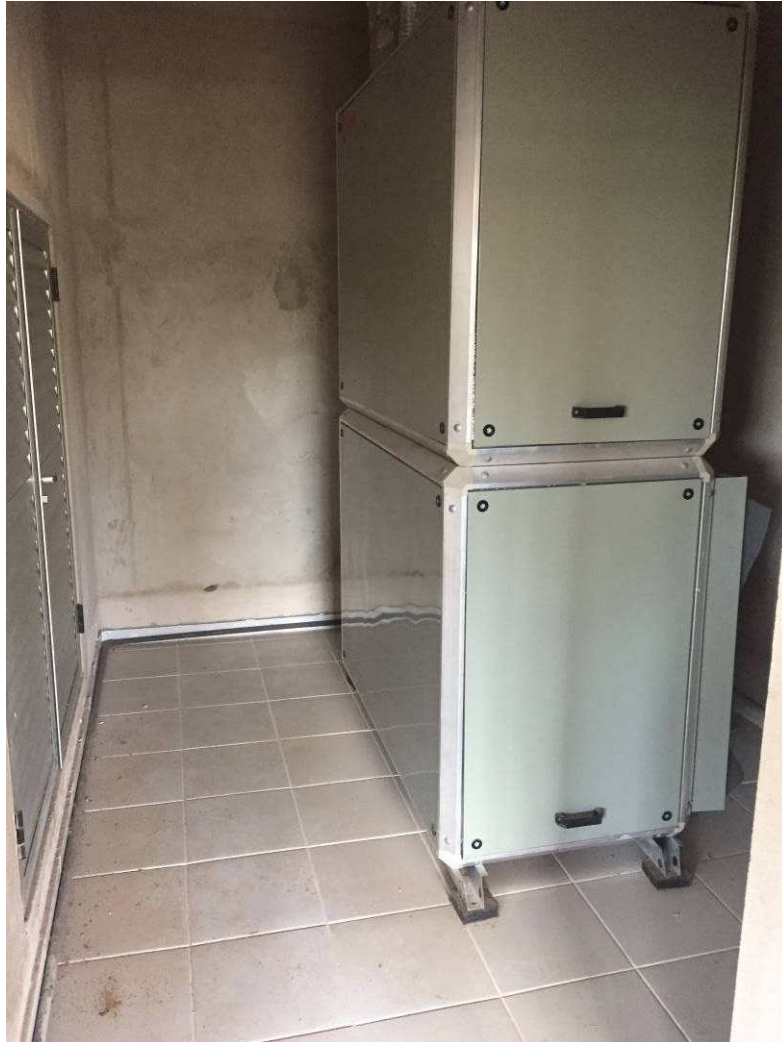
Figura 08 – Condicionador de ar não está apoiado sobre base de concreto, o dreno não está executado com sifão necessário
