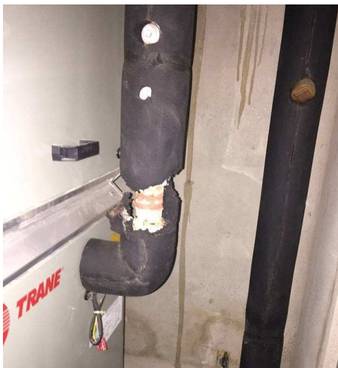
Figura 15 – Isolamento térmico danificado
