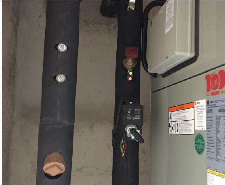
Figura 22 – Faltando fechamento elétrico das válvulas de 02 vias
