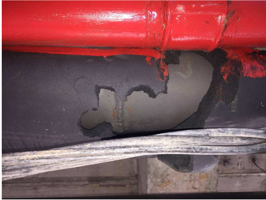
Figura 12 – Isolamento térmico danificado
