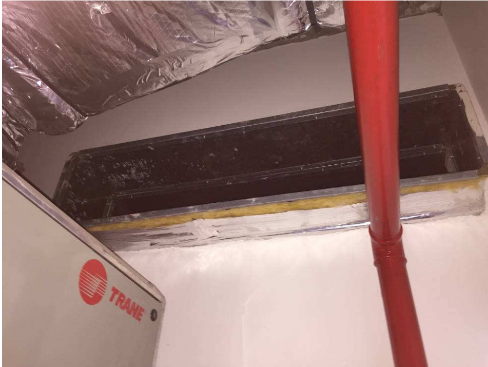
Figura 27 – Rede de duto de retorno de ar sem registro de ar
