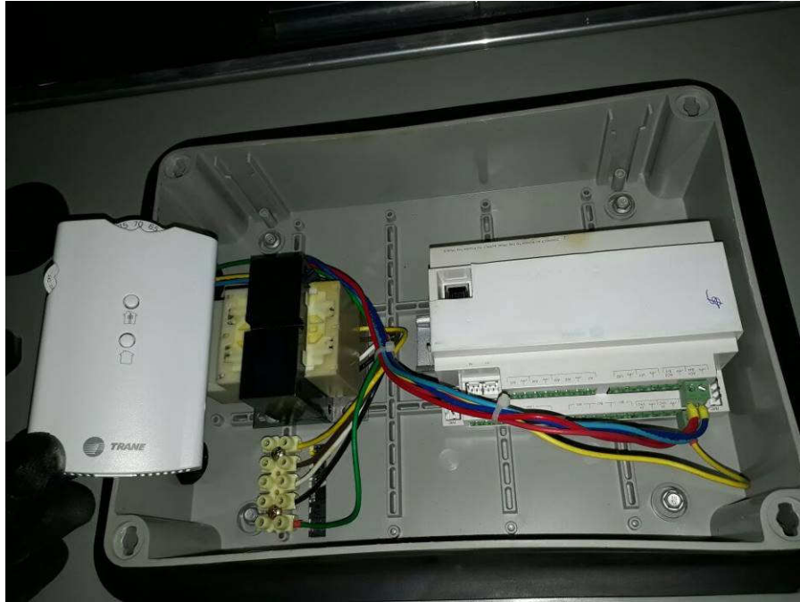
Figura 24 – Quadro elétrico dos Fancoils sem alimentação elétrica
