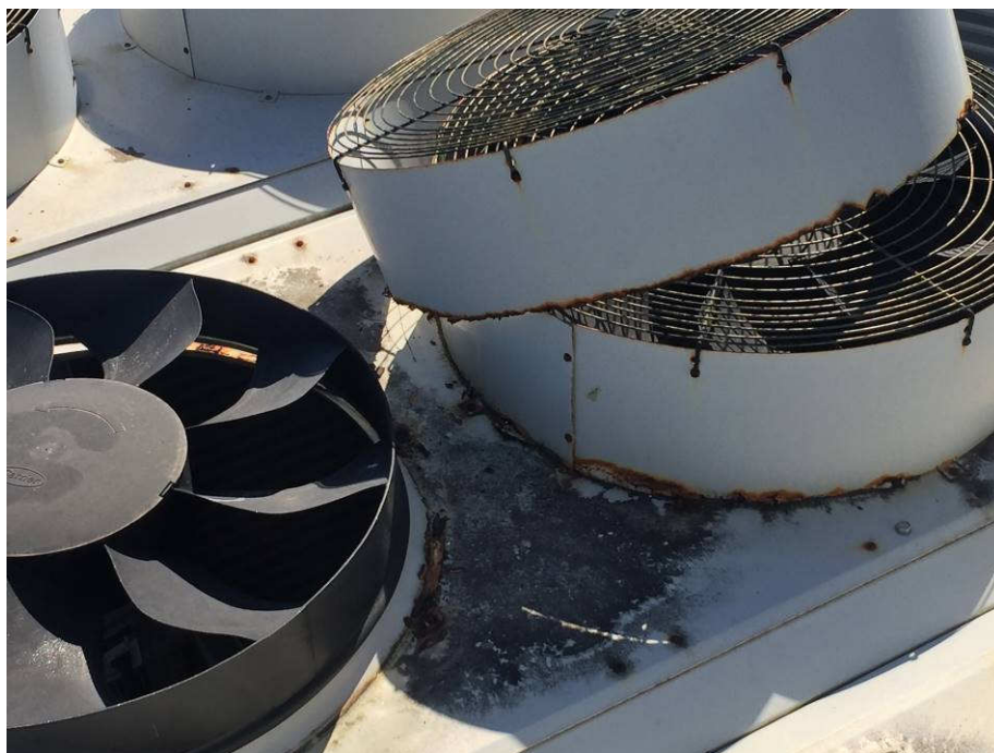
Figura 02 – Proteção dos ventiladores desmontando em função da corrosão
