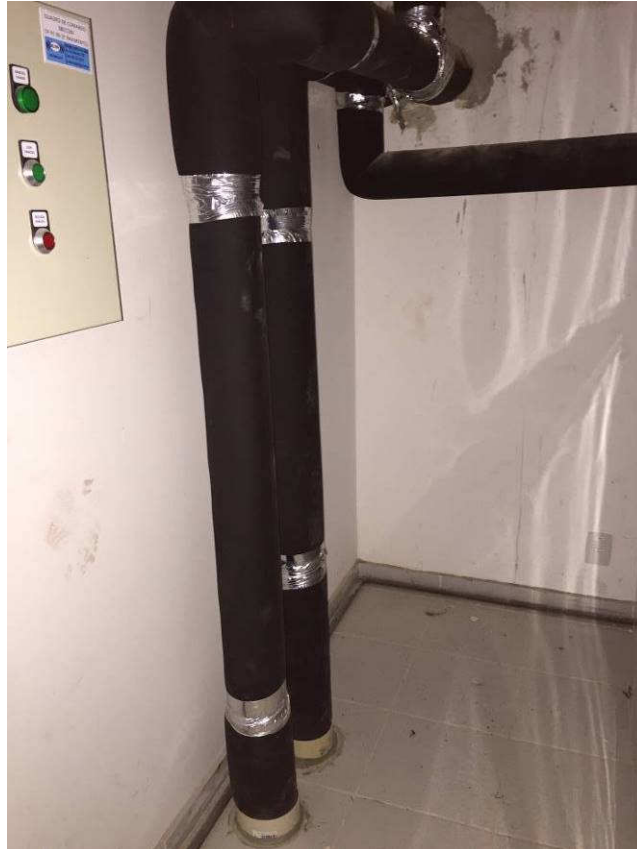
Figura 16 – Isolamento térmico com junções coladas incorretamente
