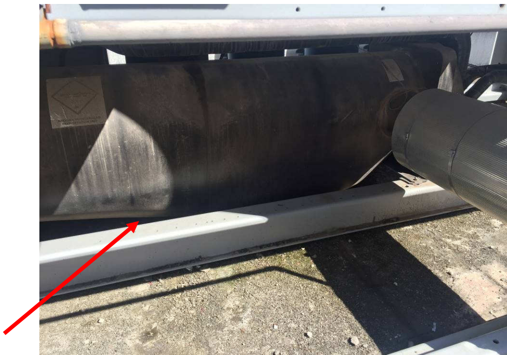
Figura 05 – Isolamento térmico do evaporador do chiller está aberto
