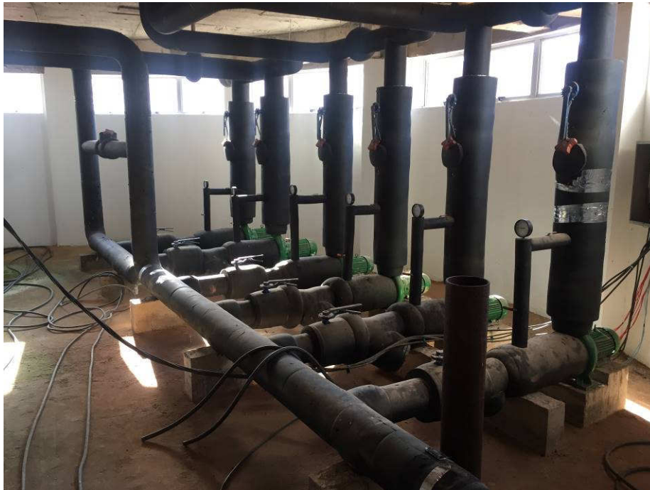
Figura 06 – Bombas centrífugas de circulação de água gelada
