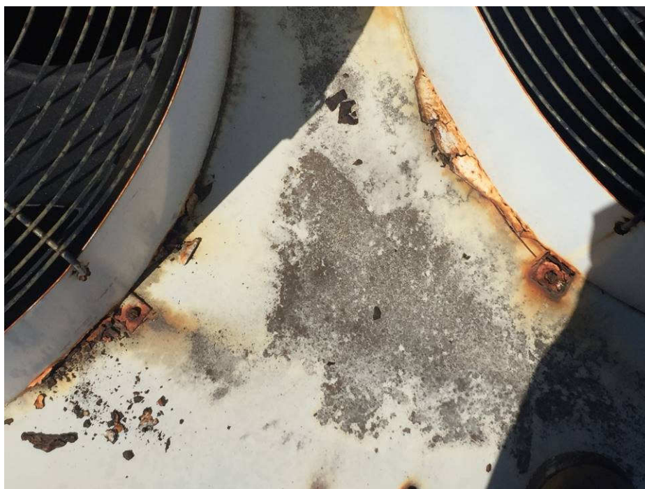
Figura 03 – Carcaça do chiller apresenta corrosão
