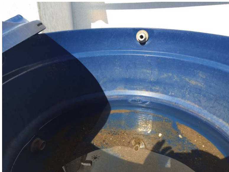
Figura 17 – Compensação de água da rede hidráulica sem nenhum controle
