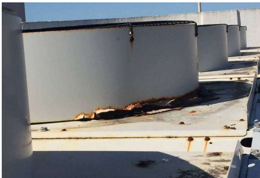
Figura 01 – Carcaça do chiller apresenta corrosão bem como toda parafusação
