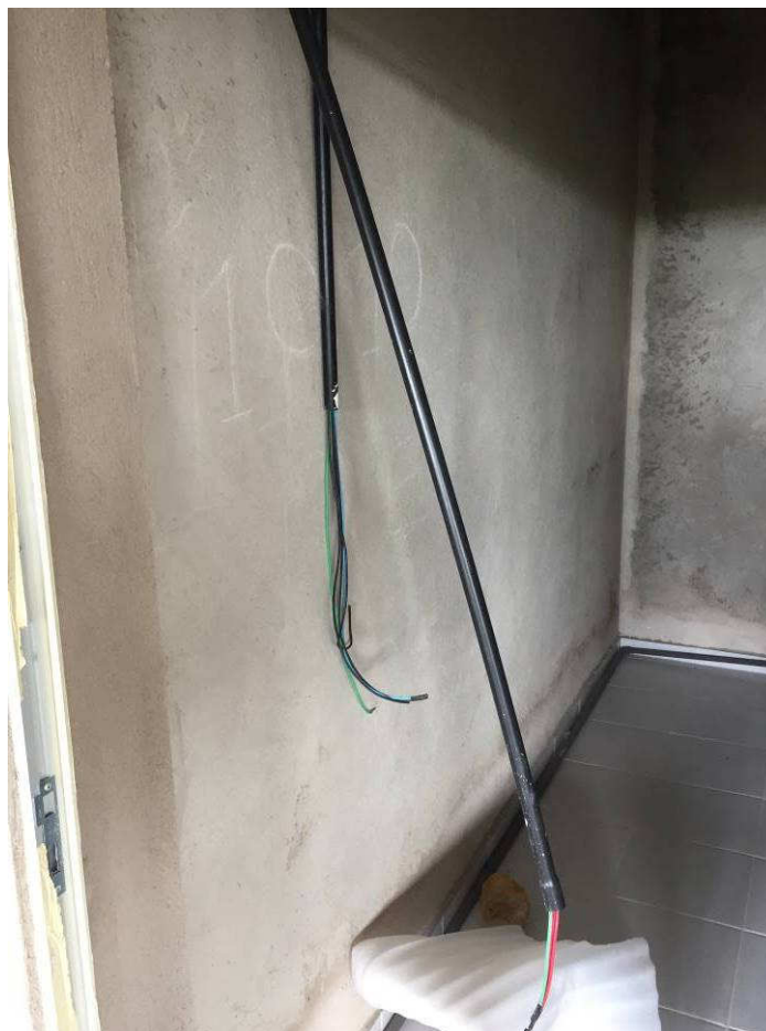
Figura 23 – Casa de máquinas sem quadro elétrico
