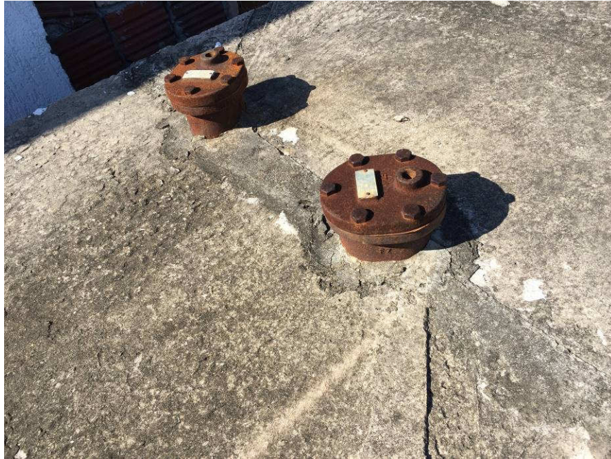
Figura 10 – Purgador de Ar totalmente oxidado e chumbado na canaleta de concreto
