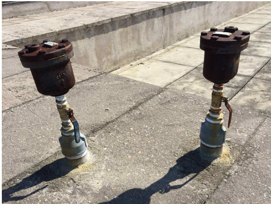
Figura 09 – Purgador de Ar totalmente oxidado
