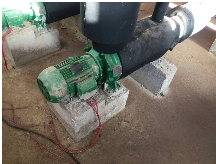
Figura 21 – Cabeamento de alimentação elétrica dos motores das bombas instalados de modo incorreto, sem proteção e fora de padrão normativo
