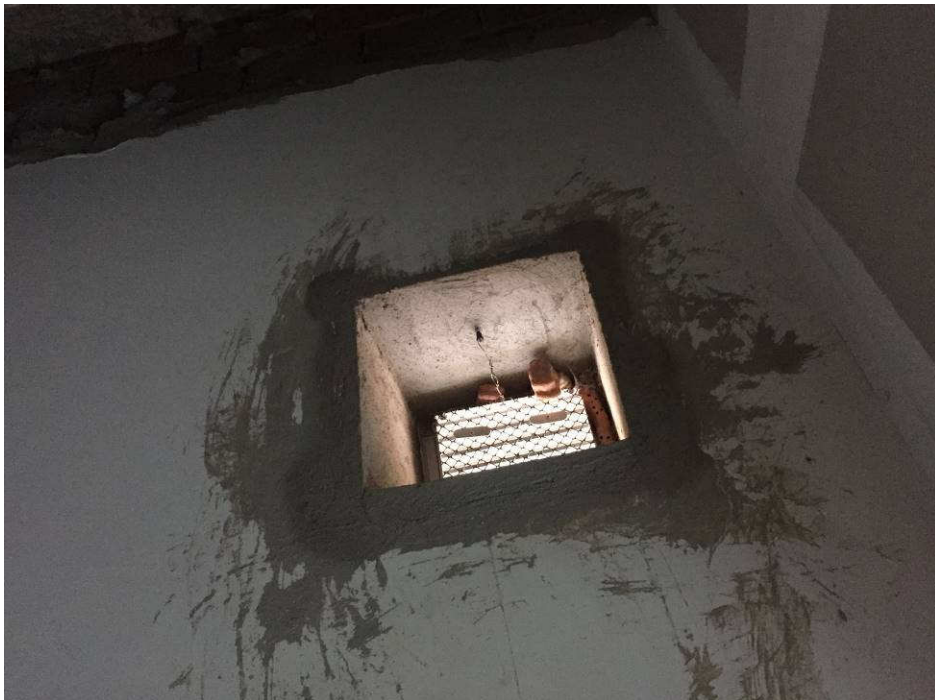
Figura 28 – Tomada de ar sem filtro metálico lavável e registro de ar
