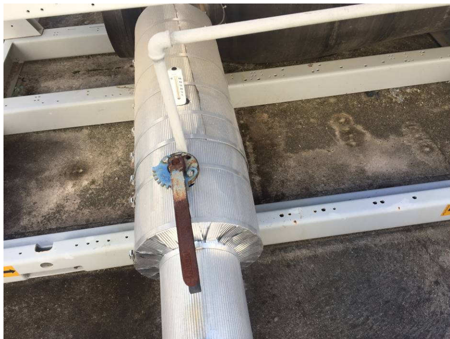
Figura 11 – Haste da válvula após processo de corrosão
