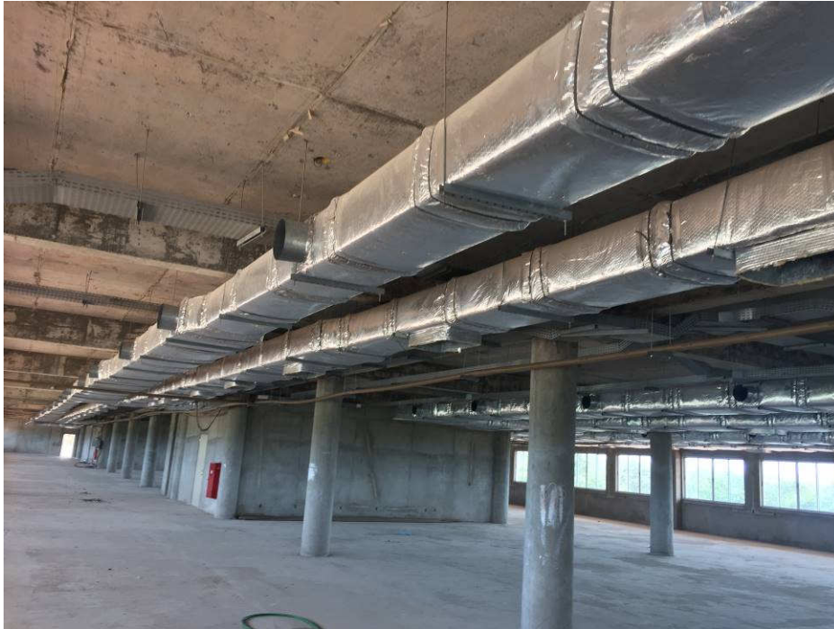
Figura 25 – Distribuição de ar executada parcialmente
