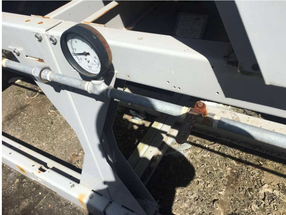
Figura 04 – Manômetros, termômetros e conexões também estão em processo de oxidação
