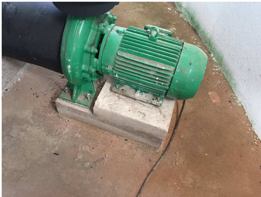
Figura 07 – Bombas centrífugas de circulação de água gelada fixadas sem base inercial e amortecer de vibração
