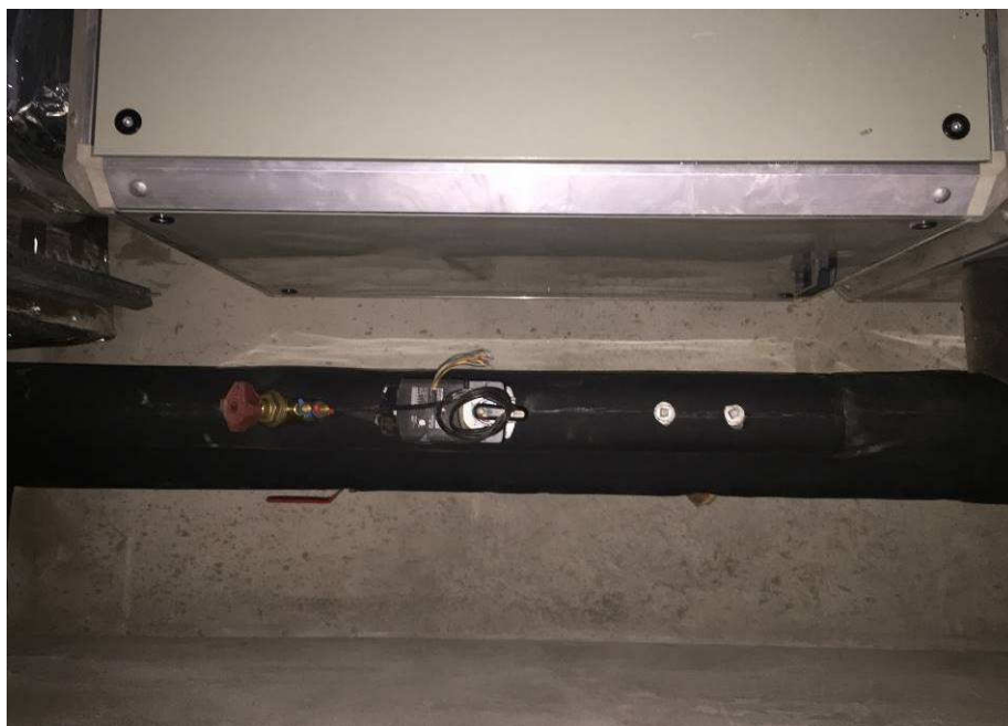
Figura 14 – Cavaletes hidráulico dos Fancoils sem termômetro e manômetro
