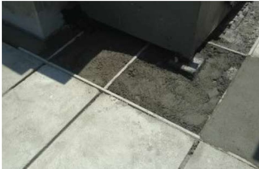
Proteção mecânica acabada em quadros
