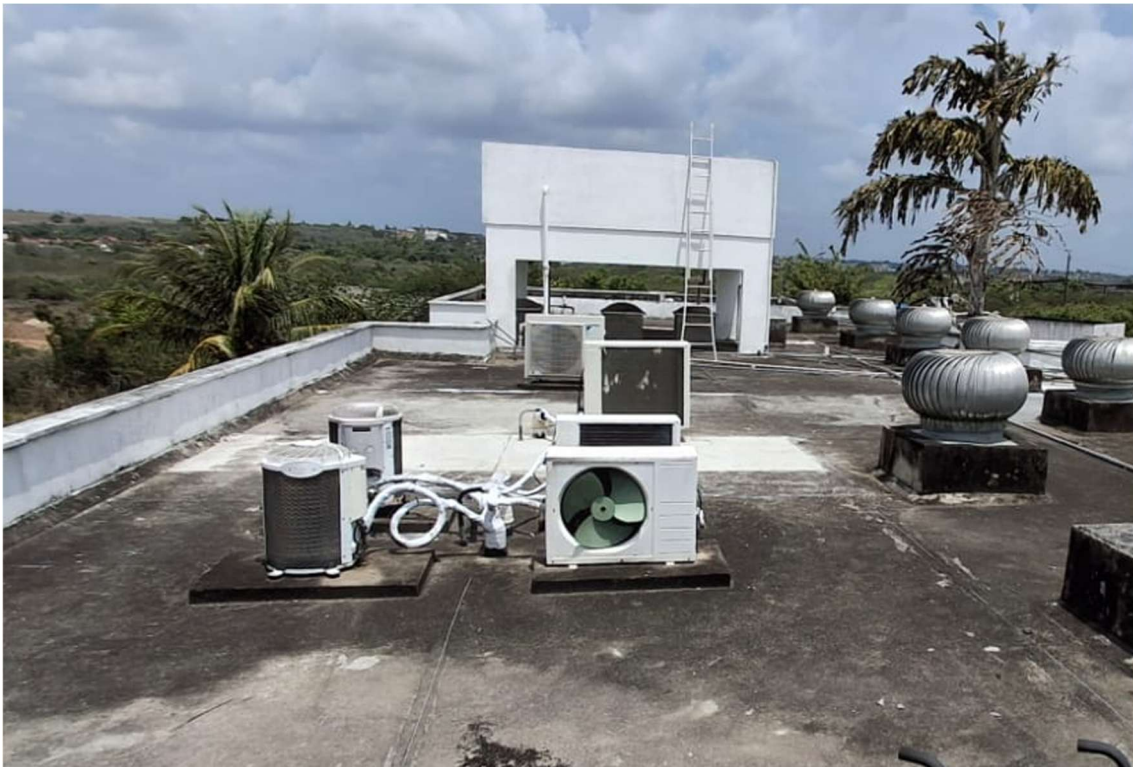
Equipamentos de ar-condicionado existentes.
