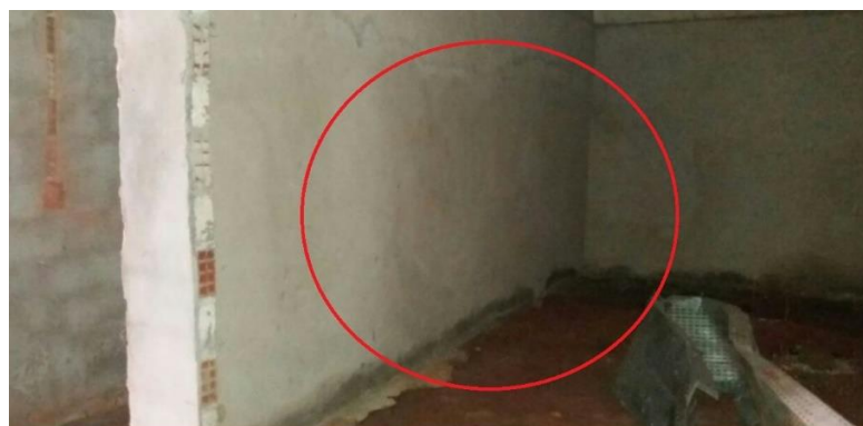
Imagem 9 – Local de instalação do QDG
