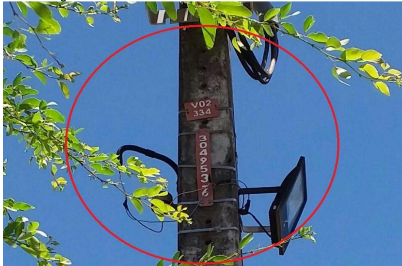
Imagem 2 – Detalhe da numeração do transformador de Candelária
