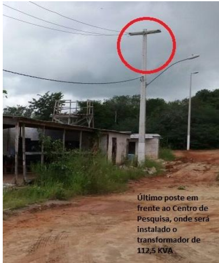
Imagem 4 – Ponto de instalação do primeiro transformador de 112,5Kv
